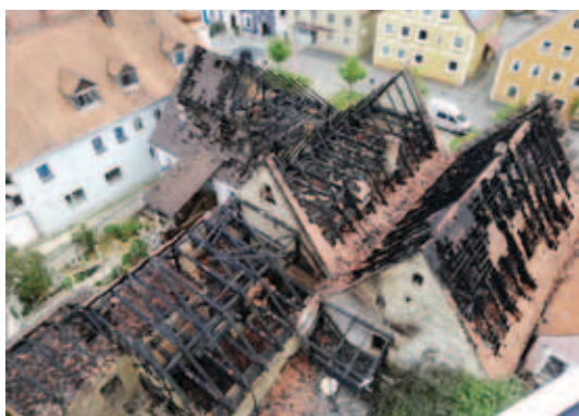
25.05.2020, Dachstuhlbrand Hohenburg (Lkrs. Amberg-Sulzbach)
