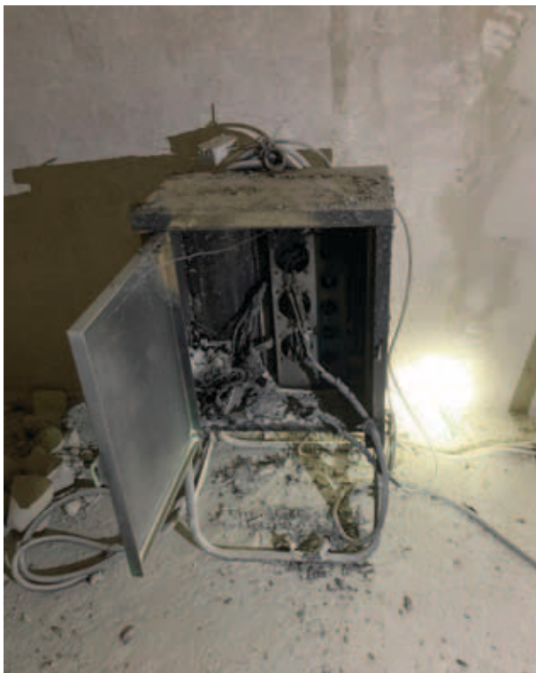
06.11.2021, Brand Baustromverteiler Steingutstraße
